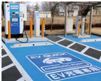
新設された急速充電設備
