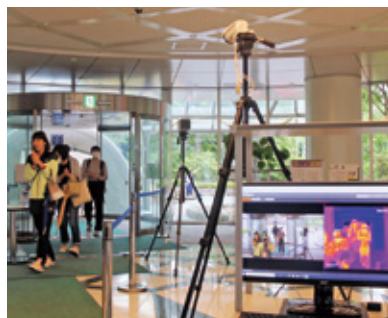
大学本館入口のサーマルカメラ
